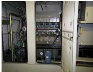
コージェネレーションシステム (ガス発電機)
