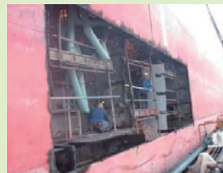
損傷した右舷外板を切り取った状態
