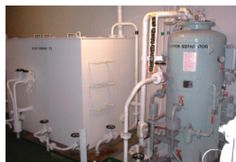
ビルジプライマリータンク（左） ビルジセパレーター（右）
