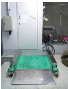
廃棄物計量器 (汐留芝離宮ビルディング)
